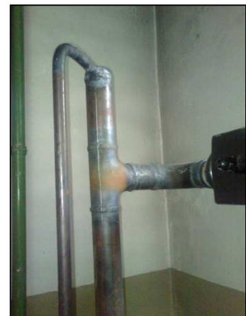
Abb.1: Entlüftungsleitung mit Lufttopf
